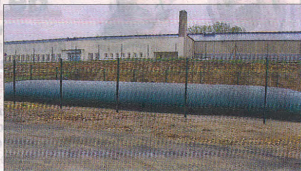
La réserve de défense incendie, d'une capacité de stockage de 80 m 3 d'eau.
