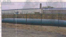
La réserve de défense incendie, d'une capacité de stockage de 80 m 3 d'eau.
